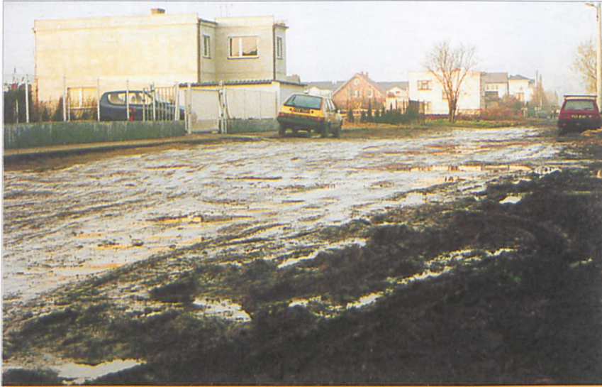
Ulica Rydla (widok od strony ul. Podgórznej) – częste opady sprzyjają tworzeniu się kałuż oraz błota. Utrudnia to poruszanie się mieszkańcom pobliskich posesji, gdzie nie ma chodnika. Dalszy ciąg ulicy, która prowadzi do ul. 1 Maja, i jest drogą do szkoły dla wielu uczniów, nie wygląda lepiej. (B)
