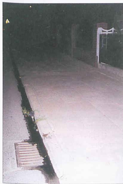
Nocną porą czarna struga ścieków z myjni wpływa do kanału
