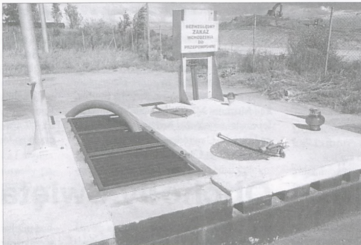
Przepompownia ścieków – miejsce tragedii. Na pierwszym planie właz (z kwiatami) przez który mężczyzna zszedł do wewnątrz po wąż. Z lewej – dziś przykryta kratami szczelina, która wcześniej zabezpieczona była jedynie położonymi na niej starymi drzwiami. W tym miejscu wpadł wąż
