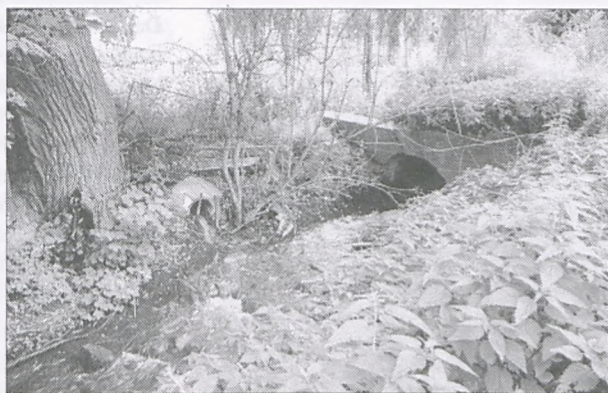
Obecny wylot potoku od strony ul. Puszkina. Mijamy nadzieję, że po regulacji Potoku Junikowskiego znikną dzikie przyłącza ścieków.
