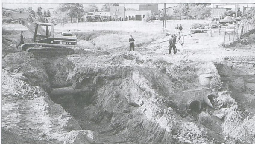
Budowa obwodnicy dla wód Potoku Junikowskiego. W głębi, za widoczną w wykopie rurą, zginął człowiek. Zdjęcie wykonano w chwili po wypadku.
