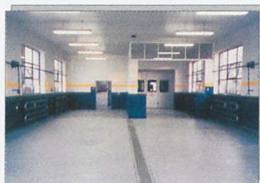
Hala lakierni - w głębi kabina bezpyłowa firmy GARMAT
