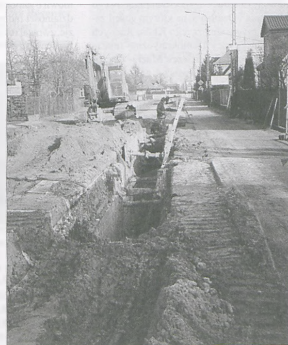
Ul. Sobieskiego od strony Żabikowskiej – firma INEX kontynuuje budowę kanalizacji w kierunku ul. Fabrycznej
