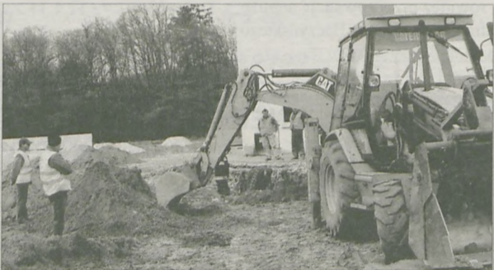
KOPARKA USZKODZIŁA przyłączy doprowadzające gaz
