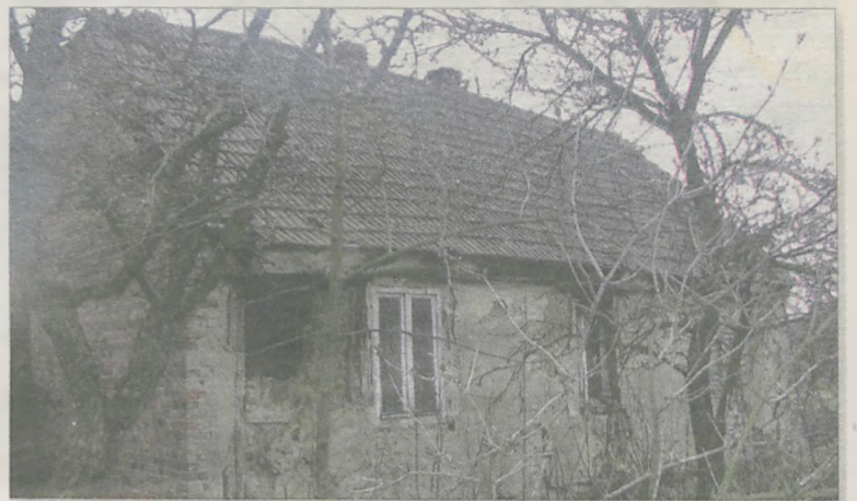
JEDNO Z POMIESZCZEŃ jej domu jest zarwane
