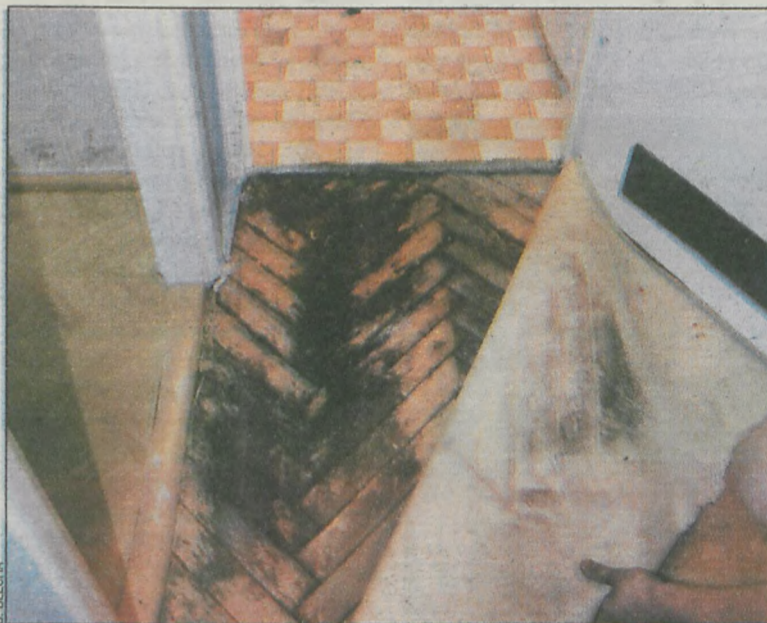
Zbierająca się pod wykładziną woda doprowadza do wyprężenia podłogi
