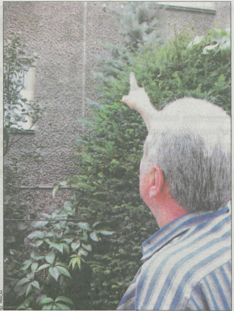
Jerzy Przewoźny pokazuje zarysowaną ścianę swojego domu
