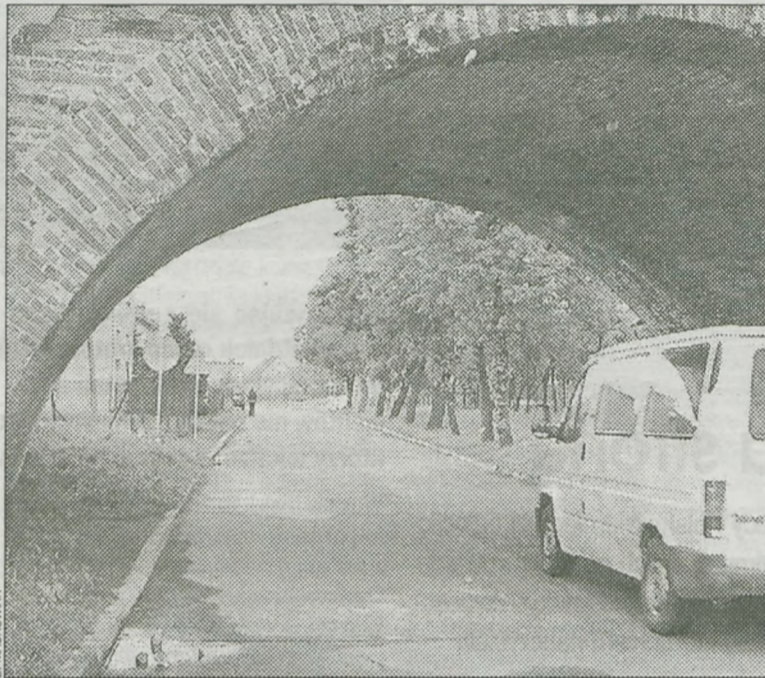
Na lewą stronę jezdni znów upadło kilka cegieł
