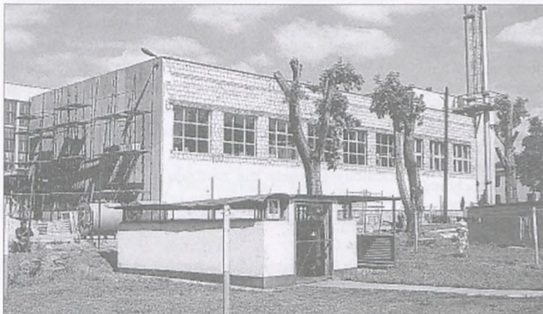
W sali gimnastycznej SP 3 wymieniono już okna. Na zdjęciu - prace przy ocieplaniu budynku.
