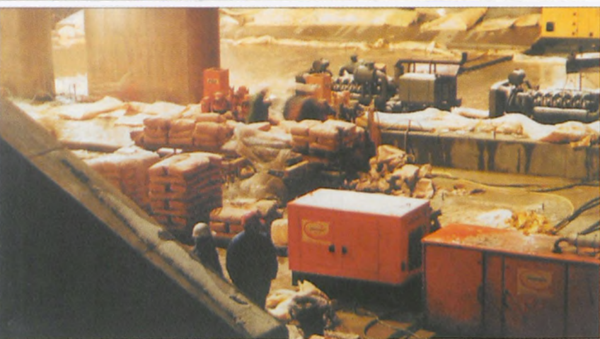
ryc. 13 W nocy z soboty na niedzielę wciągano masę uszczelniającą pomiędzy podłożem a blokiem stabilizującą w ten sposób grunt pod tunelem.
