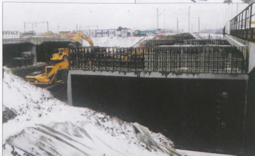
ryc.8 Następne zdjęcie wykonane z tego samego miejsca ukazuje, że blok tunelu przesunięto w lewo o około 8m.
