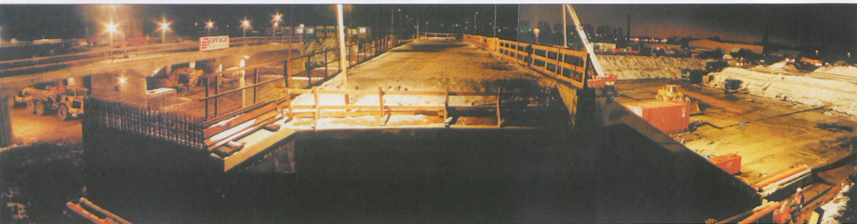
ryc.12 Nocna panorama placu budowy widziana z punktu B, tak jak ryc.4. Po lewej widoczny blok stały i przerwa technologiczna, pośrodku ustawiony już na swoim miejscu blok ruchomy tunelu autostrady oraz po prawej pusta płyta poslizgowa. W tylnym planie widoczne oświetlone wieżowce na Dębie.
