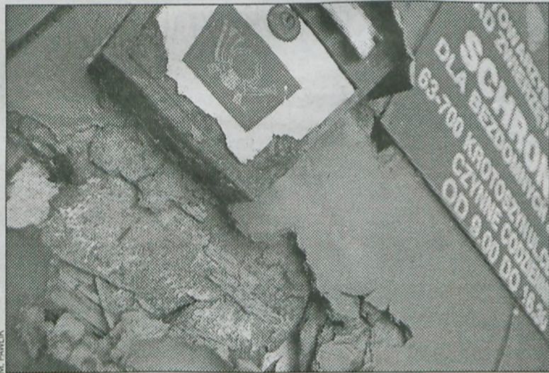
Temu pomieszczeniu remont z pewnością się przyda
