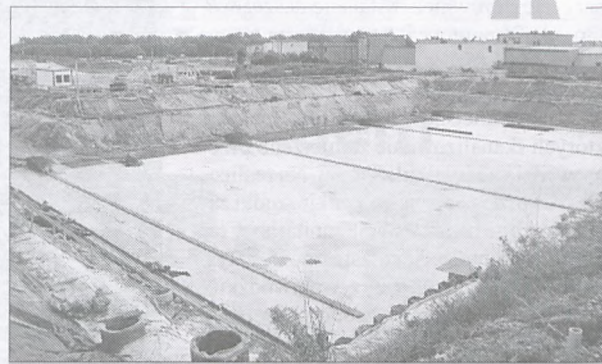
Zdj. 5. Widok z nasypu kolejowego Poznań – Staroleka. W głębi zabudowania ul. Chopina.
