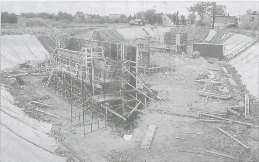
Zdj. 2. Wiadukt WD2 ul. Kościuszki. Widok od strony ul. Poniatowskiego w kierunku ul. Kotowo.
