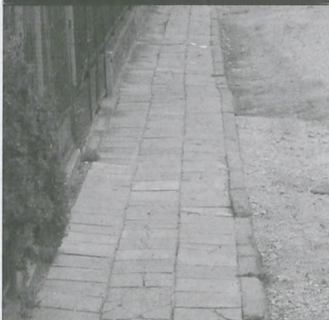
Połamane płytki chodnikowe w 95% na całej długości ulicy.
