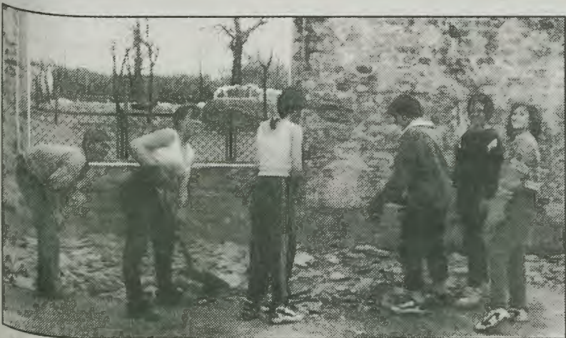
W spalonej dyskotekce młodzież z Płotna usuwa szkody pożarowe
