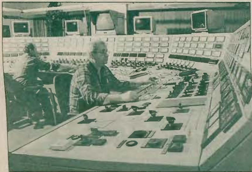
Nastawnia blokowa Elektrowni „Adamów”
