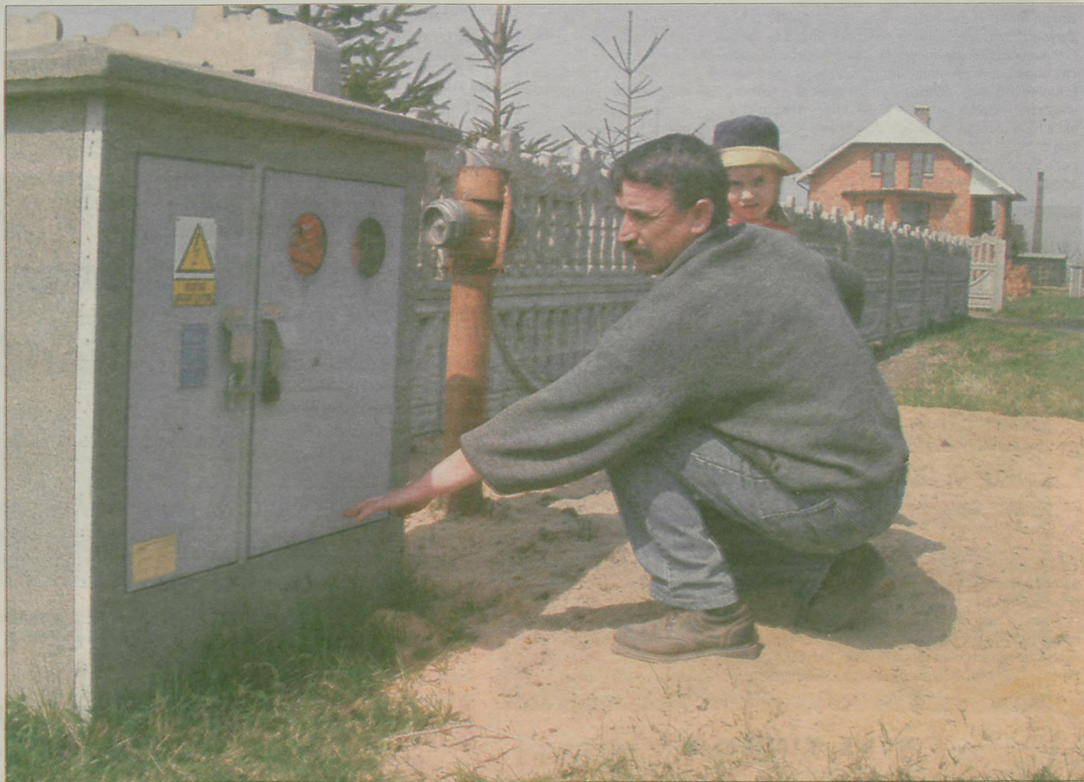
- Tu jest skrzynka z zasilaniem elektrycznym. Jak nas zalewało, to wychodziliśmy z domu przez działkę sąsiada, bo strach było tędy, przez podwórko się ruszyć. Jak radni przyjechali i zobaczyli, że woda stoi wokół skrzynki, to się bali wysiąść z samochodu, żeby ich prąd nie poraził - mówi Jacek Marek pokazując, do którego miejsca sięgała woda, zanim wykonane zostało odwodnienie działek
