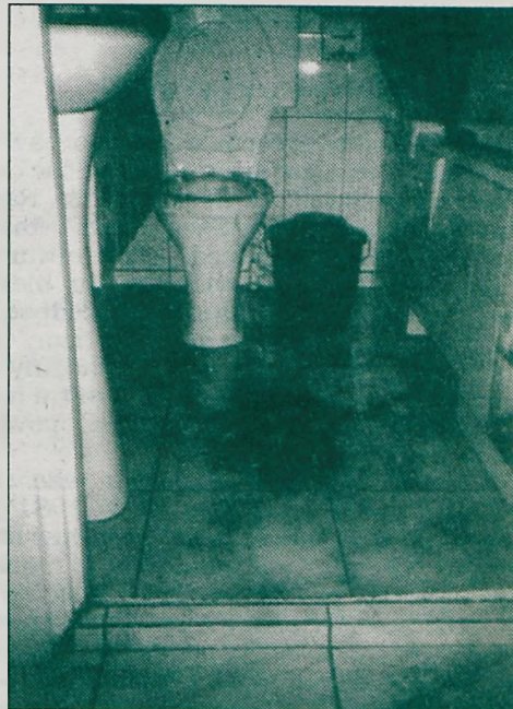
Łazienka w domu przy ulicy Kościelniczej zalana fekaliami, które cofnęły się z kanalizacji
