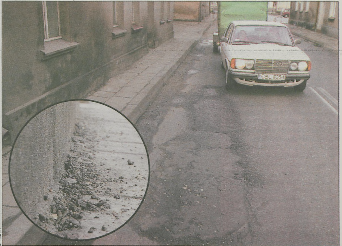
Tynk jest nasiąknięty
