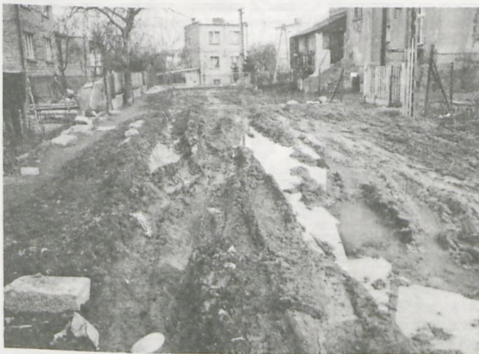
Bez komentarza. Tak wygląda ul. Paderewskiego (Pasikowskiego). W glinie koleiny dochodzą do 10 cm (w ubiegłym roku instalowano tutaj odwodnienie).
