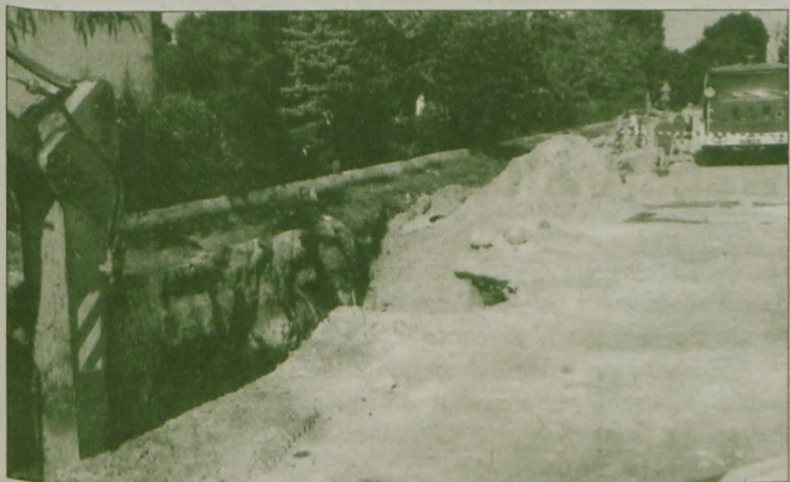
Z informacji udzielonych przez strażaków na miejscu wypadku wiadomo, że jedna ze ścian wykopów nie była zabezpieczona
