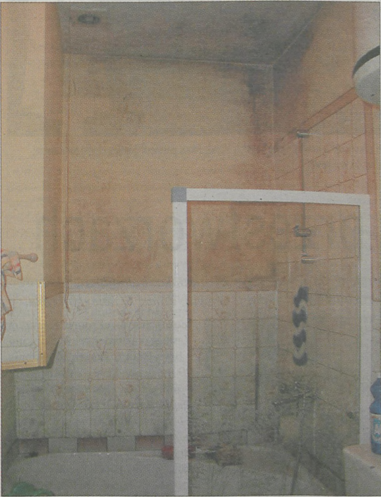
Pani Beata jest zupełnie zrezygnowana. Remont mieszkania na nic się nie zdał, wilgoć wszystko zniszczyła
