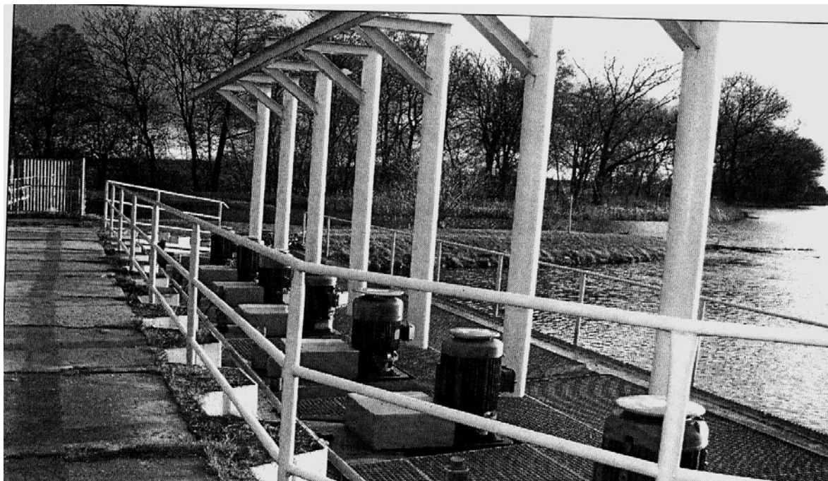
Fot 2 . Nowy przekop i nowy jaz wraz z turbinami – oddany w 2008 roku. - widok z przodu (zdjęcia autorów)
