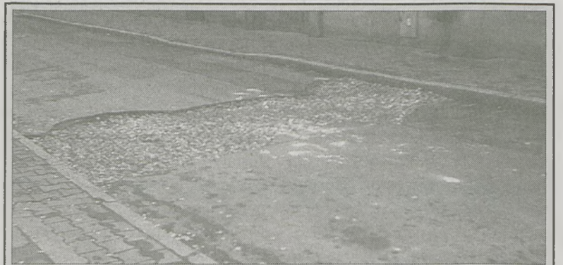
Po zakończeniu prac związanych z modernizacją sieci wodociągowej na ulicach Kilińskiego, Mickiewicza i Średniej pozostały zniszczone nawierzchnie. Henryk Chrobot, kierownik wodociągów w Przedsiębiorstwie Wodociągów i Kanalizacji w Jarocinie poinformował „Gazetę”, że w najbliższym czasie DROBUD S.A. Przedsiębiorstwo Robót Drogowych z Jarocina położy na tych ulicach nowe dywaniki asfaltowe
