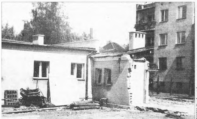
W trakcie przebudowy baraku okazało się, że trzeba go wyburzyć i postawić od nowa. Nie godzą się na to mieszkańcy bloku znajdującego się naprzeciwko
