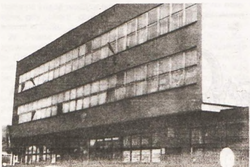
Spór trwa, a Dom Usług niszczeje.
