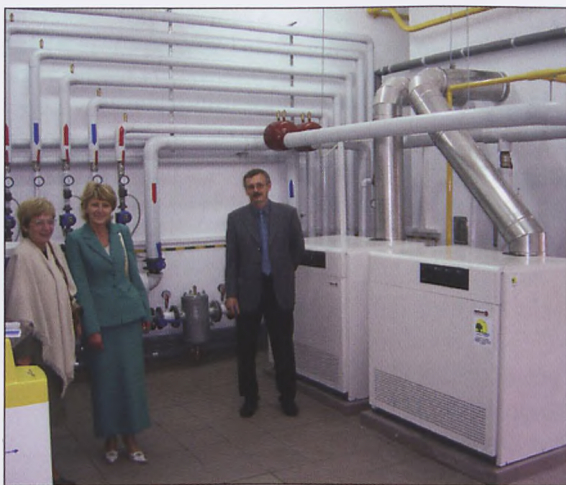
Nowa kotłownia gazowa. Ze zbiorów autorki
