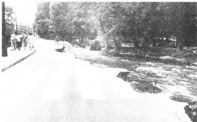
Wezbrane wody zerwały asfalt z połowy ulicy
