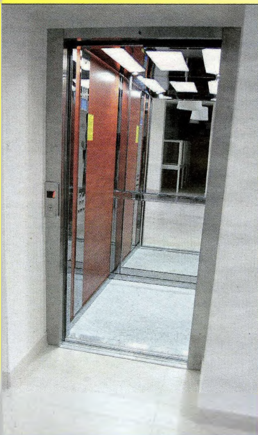
GRUDZIEŃ - Budynek wyposażony został w windę, a także szereg innych udogodnień, które pozwolą z placówki korzystać osobom niepełnosprawnym. Zamontowany został także system monitoringu, instalacje służące sygnalizacji pożaru oraz klimatyzatory. Wszystkie pomieszczenia zostały przemalowane, położone zostały także nowe płytki podłogowe oraz wykładziny. Wyremontowane zostały również toalety.
