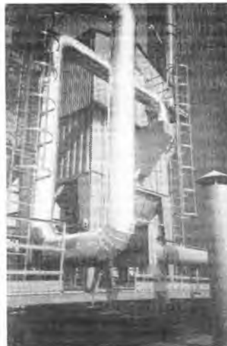
Zmodernizowana instalacja odpylająca linii do produkcji papy.
