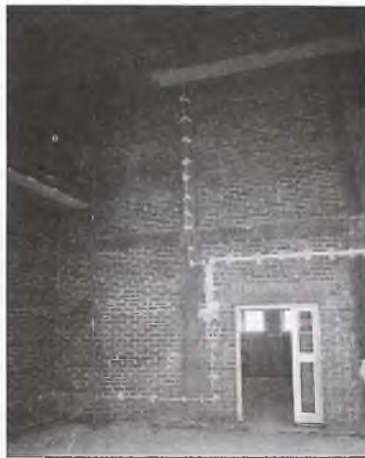
Instalacja elektryczna wkrótce zostanie zakryta przez tynk
