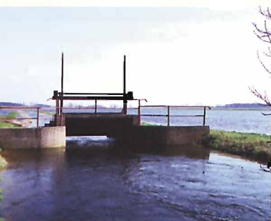
Urządzenia hydrotechniczne na Moskawie
